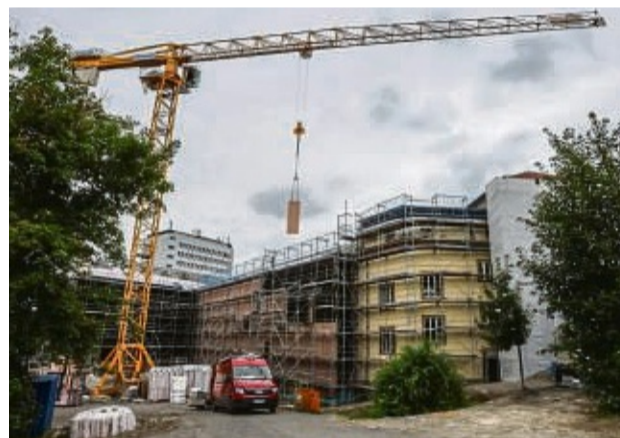
Hier wird schon die Fassade montiert: An der rückwärtigen Gebäudefront hebt ein Baukran die Betonfertigteil in Position.
