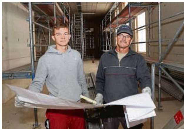
Planen für die Heizungsanlage: Konrad Ciesielski (links) und Aleksander Garmek von der Firma Heiztechnik Mühlhausen im Foyerbereich des Gebäudes.
